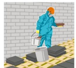
Regel 9: Wir schützen uns zuverlässig vor möglichem Asbeststaub.
